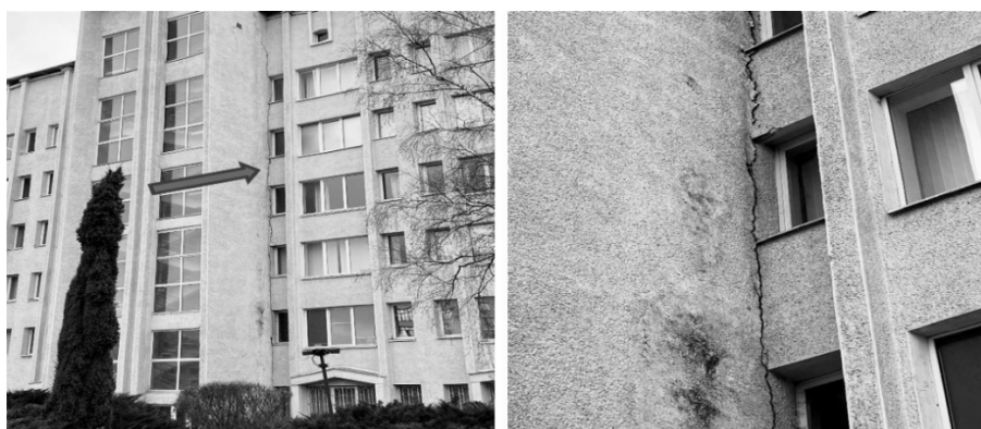
Рис. 2. Деформації будівлі корпусу №1 Івано-Франківського національного технічного університету нафти і газу
